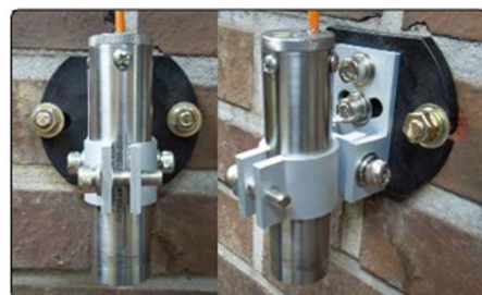
[전기식 경사계 설치 사진]
